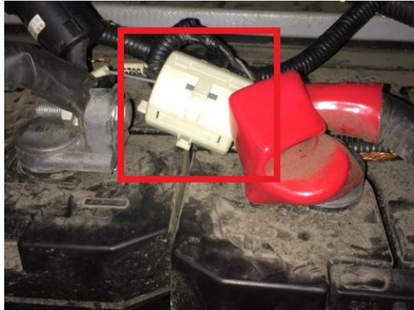
蓄电池征集馈线整改后照片
