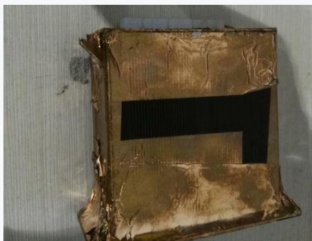
燃气报警器控制盒整改后的照片
